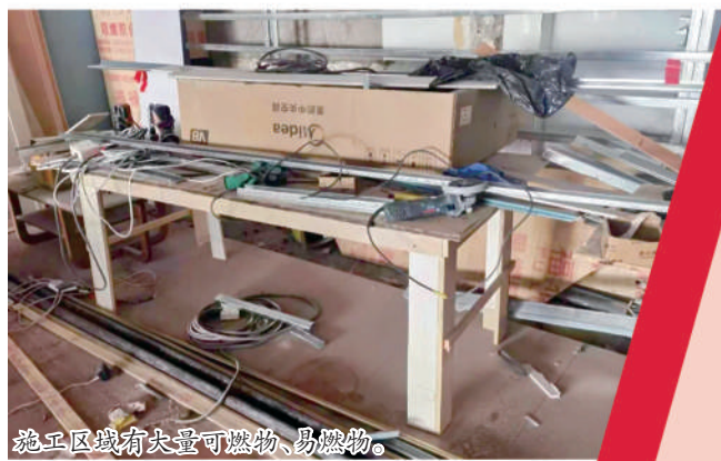
施工区域有大量可燃物、易燃物。
